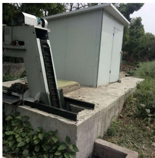
污水处理设施
