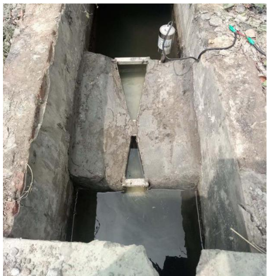
污水处理站进口
