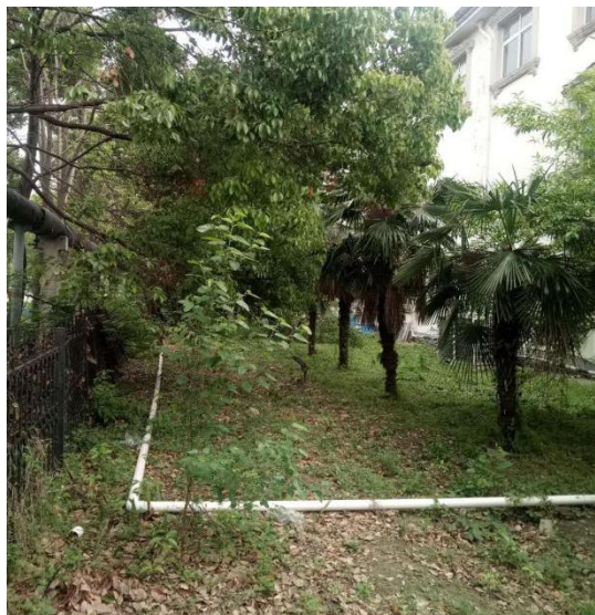
办公区废水排水管（排至污水站）
